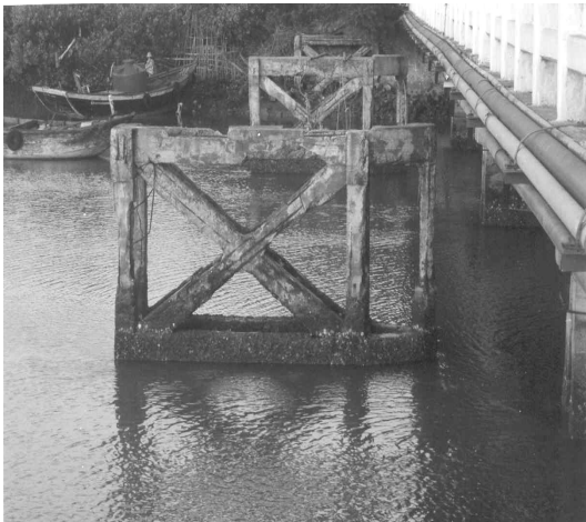
a) Phần dưới mặt nước bê tông còn tốt, cốt thép chỉ bị gỉ nhẹ
