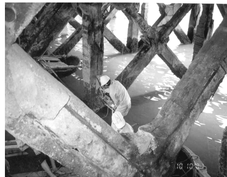
b) Phần trên mặt nước bị ăn mòn và hư hỏng rất nặng tới mức không sử dụng được
