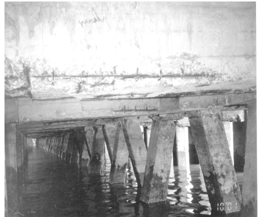
Hình 4.8: Ví dụ hiện trạng ăn mòn và hư hỏng cảng Cửa Cấm - Hải Phòng, cách biển 25 km, sau 30 năm (khảo sát 2001)
