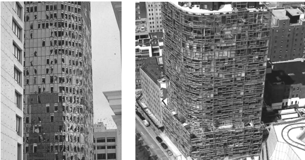
Hình 15.2: Hình ảnh một số phá hoại của hệ mặt dựng nhôm kính do gió bão
