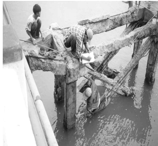
b) Phần trên mặt nước bị ăn mòn và hư hỏng rất nặng tới mức không sử dụng được
