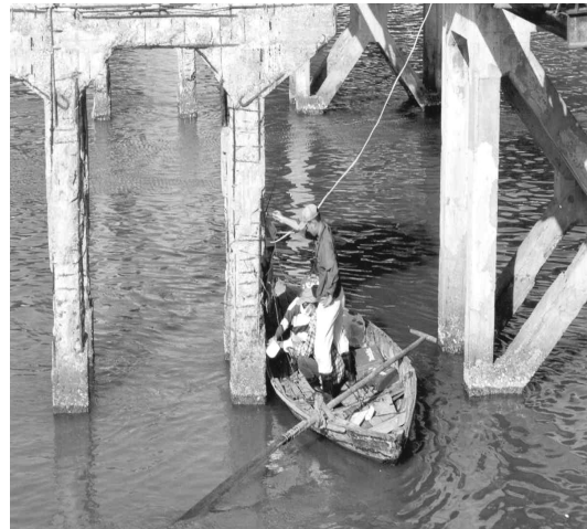
b) Phần trên mặt nước bị ăn mòn và hư hỏng rất nặng tới mức không sử dụng được
