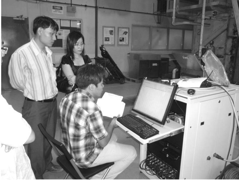
Hình 15.18: Hệ thống điều khiển trung tâm
